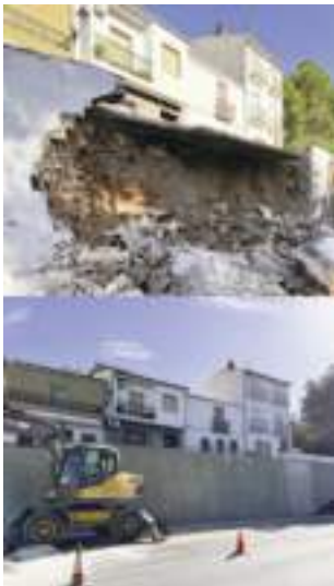
Antes y después desprendimiento Muro Marqués de Santillana.
